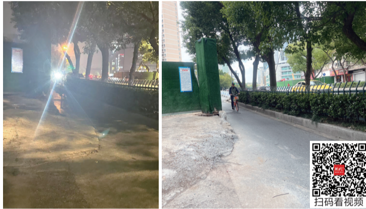
凸出慢车道的水泥斜坡被铲除,左图为事发时水泥斜坡侵占慢车道(周女士提供)
