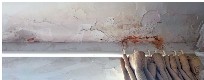
渗水导致阳台顶上的腻子脱落
