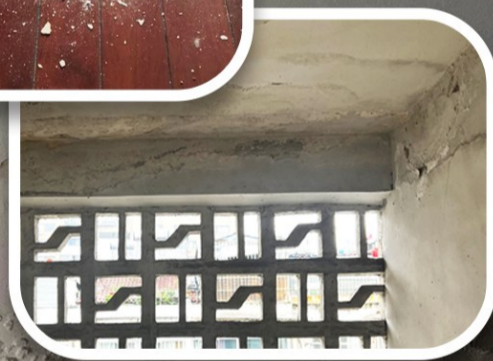
赵先生所在单元楼道里的渗水痕迹
