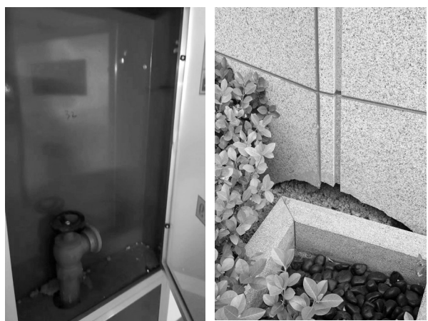
小区消防设施不全 业主供图
