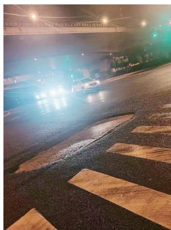
事发时路面上留下的施工坑，浇了混凝土还没有铺上沥青，与路面有一定落差 当事人供图
