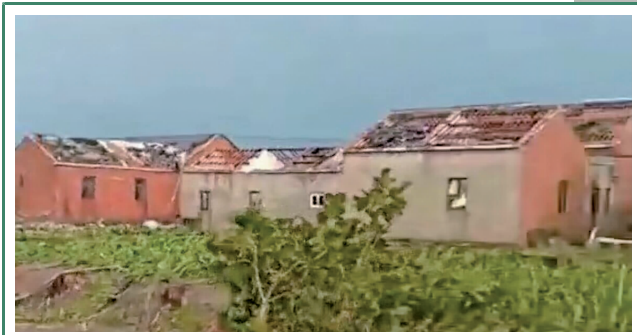
龙卷风掀掉了屋顶 网友供图
