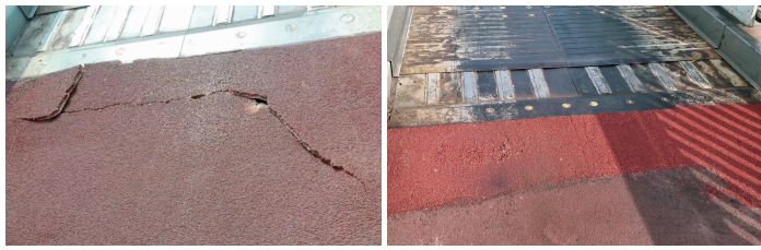
网友反映的路面裂缝
