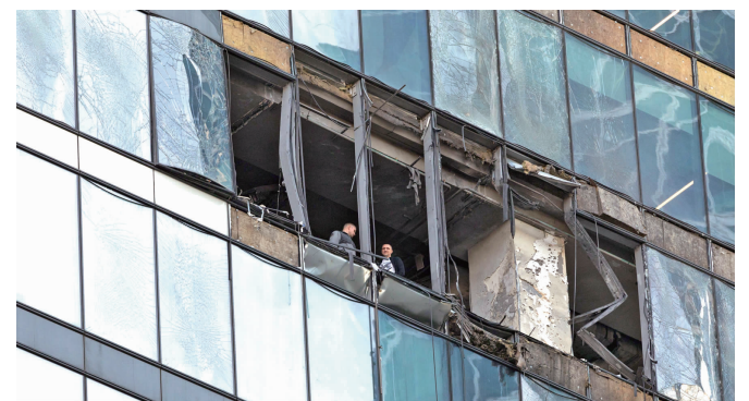
8月1日在莫斯科拍摄的受损建筑 新华社记者 白雪骥 摄
