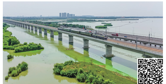
调试列车驶过沪宁沿江高铁常州特大桥梁湖段 王昊 摄 扫码看视频
