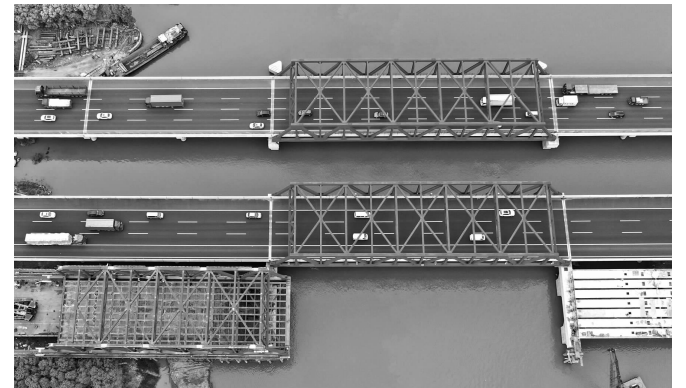
4月25日拍摄的沪宁高速公路青阳港大桥南半幅钢桁梁施工现场(无人机照片)。
