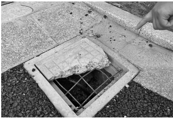
基础设施损坏 现代快报+记者 姜振军 摄
