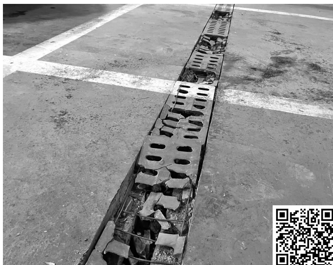
地库雨水篦子损坏严重 现代快报+记者 孙玉春 摄 扫码看视频
