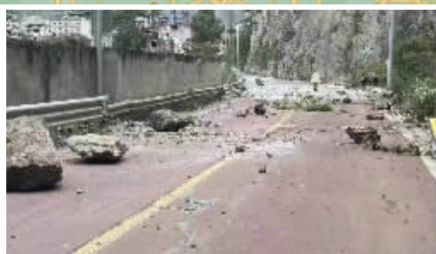
山石掉落在泸定县冷碛镇附近的道路上 新华社发
