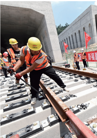
8月30日,施工人员在新建福厦铁路厦门北站施工现场作业 新华社发
