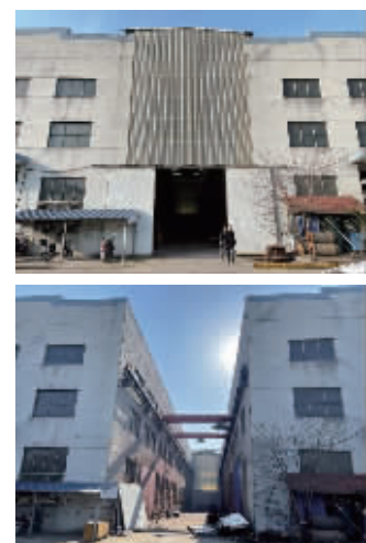
违建拆除前(上)后 新吴城管供图
