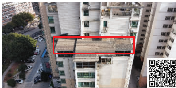
楼顶违建航拍图 现代快报+记者 谢喜卓 摄 扫码看视频
