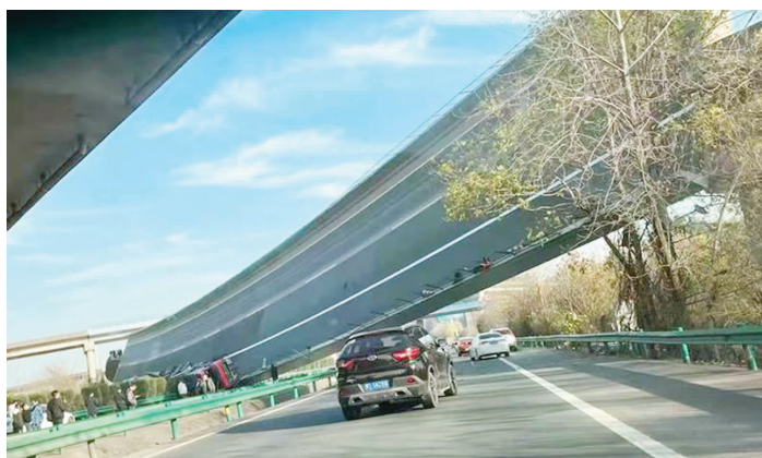
坍塌的高架桥横在路面上 网友供图
