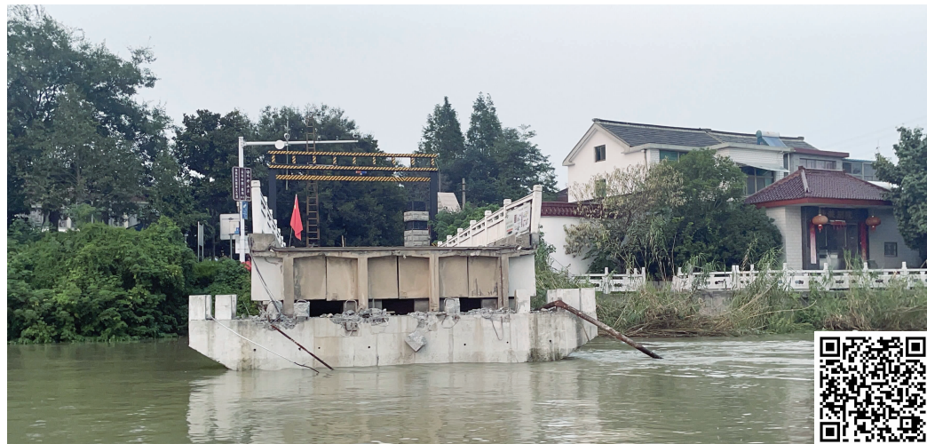
扬州壁虎大桥被撞断
