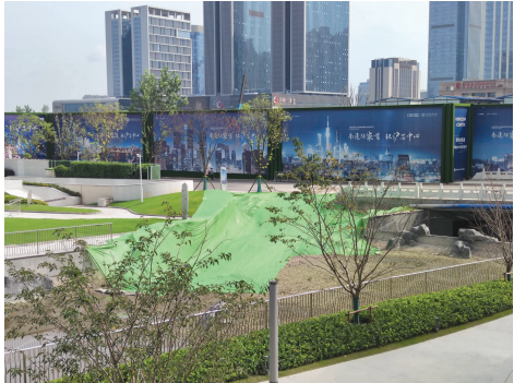
塌陷处已被绿布覆盖，周围设置围挡
