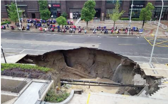
2017年6月10日塌陷事故现场 图片据媒体此前报道
