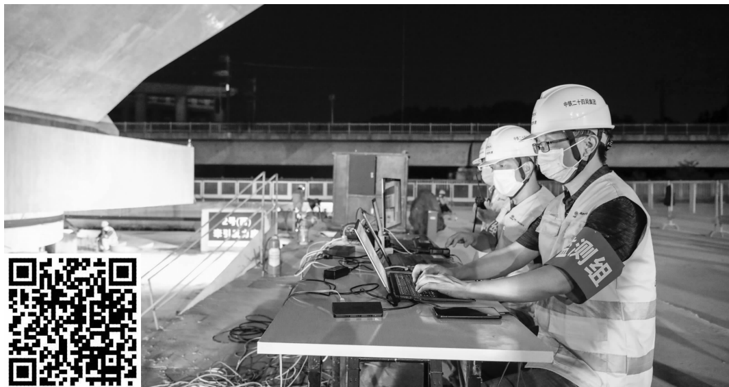
施工人员在现场操作V型刚构转体(扫码看视频) 通讯员供图
