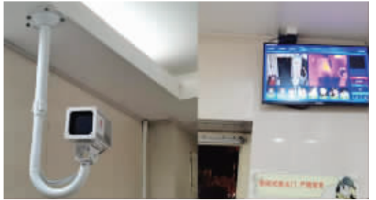
苏州市立医院北区的热成像测温系统
