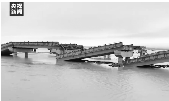
西丽高速野马滩大桥因地震双向坍塌 央视截图
