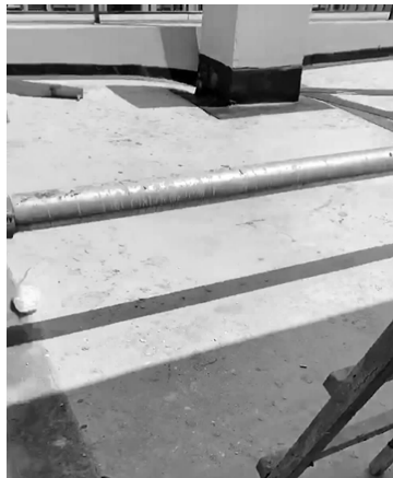
屋顶花园铺设了大量管道
