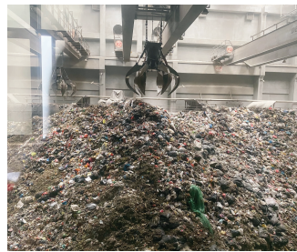
垃圾焚烧发电厂内,一只垃圾吊正在抓垃圾 现代快报+/ZAKER南京记者 张瑜/摄
