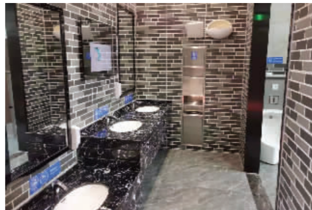
蒙古桥公厕洗手台
