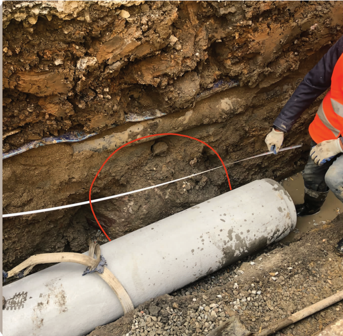
下水管已紧贴石块埋到地下(红圈处为石构件) 现代快报+/ZAKER南京记者 张然 摄
