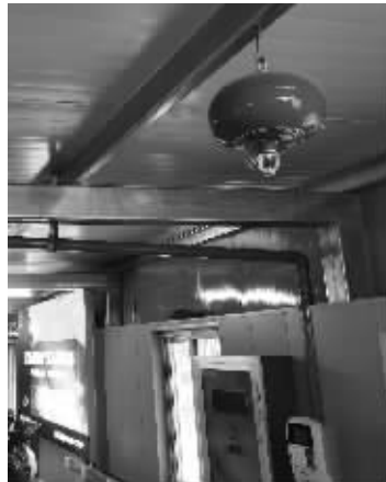
智慧车库配有监控及干粉灭火器等设备
