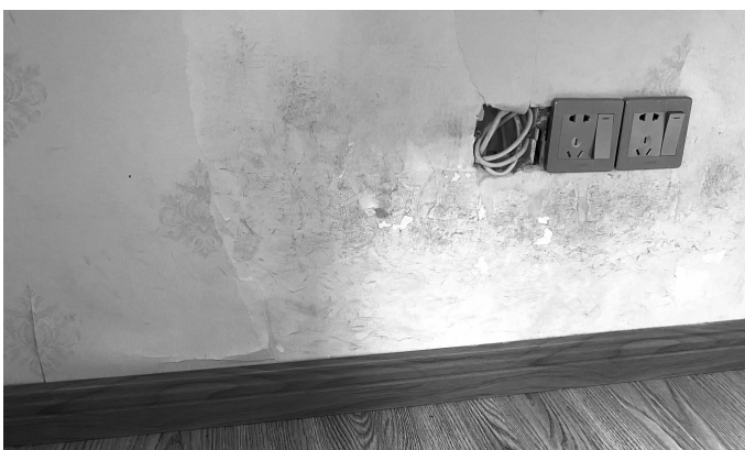
水浸泡过的墙面可见明显水渍和斑驳情况
