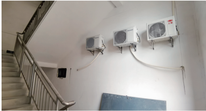
其中三台空调外机装在楼梯间墙上
