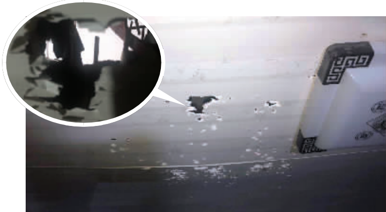
居民家的屋顶被击穿 通讯员供图
