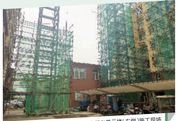
淮安城中花园郑女士所在单元楼(左侧)施工现场
