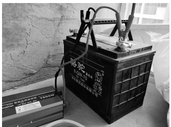
张义全的家里靠蓄电池和逆变器供电
