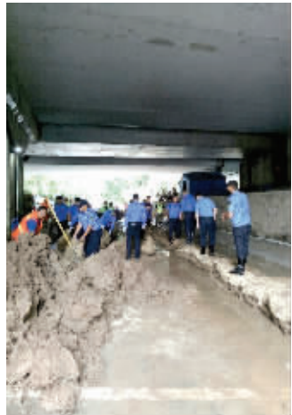
城管队员用沙袋封堵渗水和积水 (通讯员供图)
