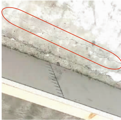
孔女士购买的新房出现多处裂缝
