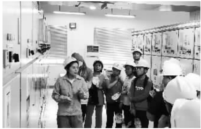
参观同安变电站内部设备 学校供图
