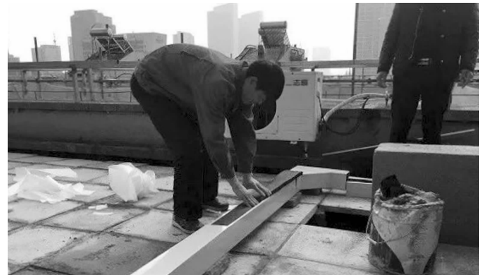
给楼顶明露水管制作护套管进行保温 南京市水务集团供图
