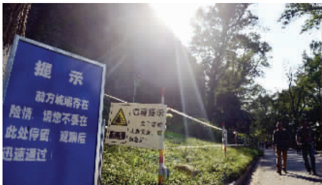
这段城墙裂缝变大(上图);城墙下竖起了警示牌(下图)
