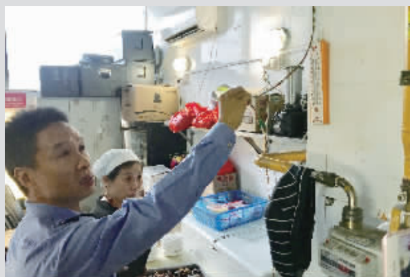
外卖店里电线私拉乱接的情况比较多,存在安全隐患
