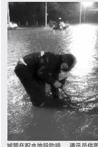
城管在积水地段助排 通讯员供图
