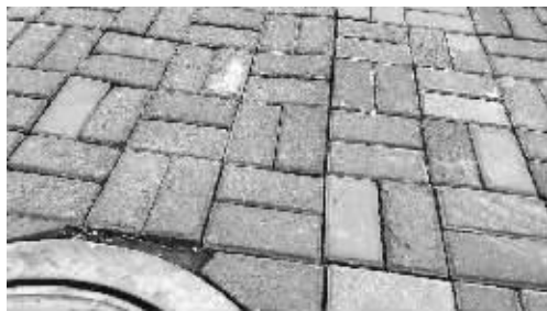
回填后的路面明显沉降
