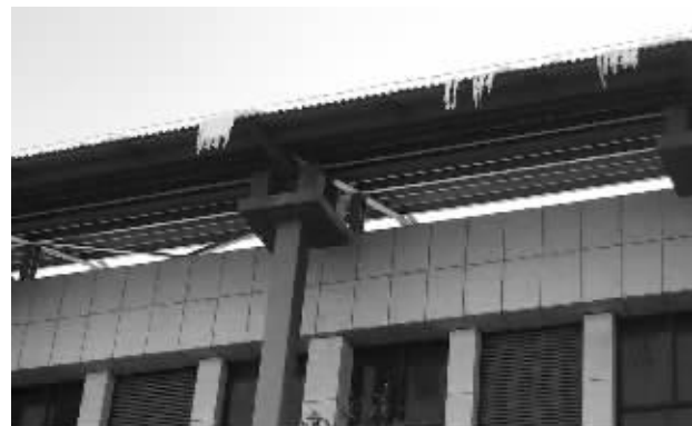
屋檐上的冰凌摇摇欲坠 警方供图
