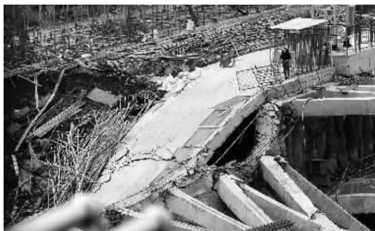
基坑局部支护桩发生大面积塌陷
