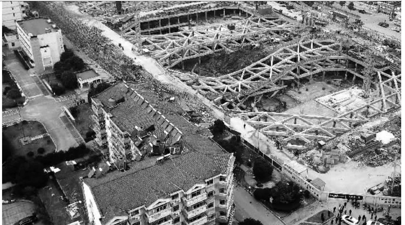
工地基坑塌陷,塌陷区距离旁边居民楼最近的地方只有五六米远,居民及时撤离无人员伤亡
