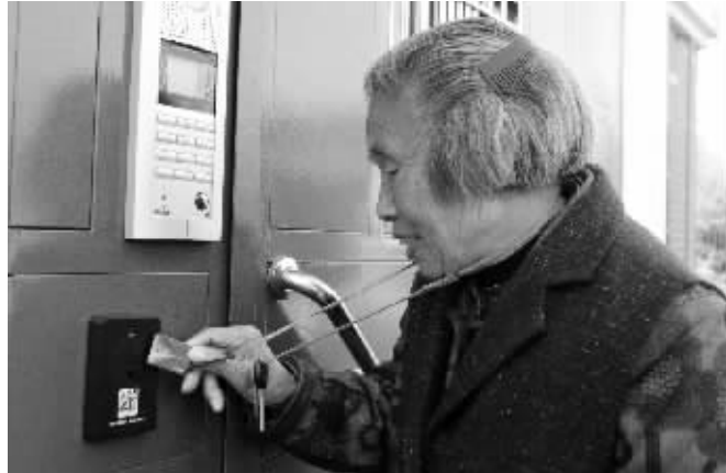
凭门禁卡“一卡通”进入小区单位楼道、地下车库 相萱供图
