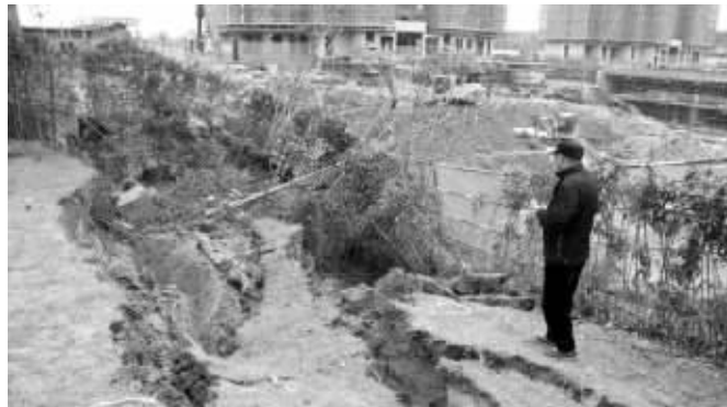
工地基坑坍塌现场
