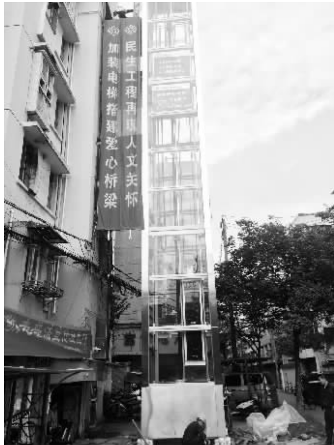
►南京后宰门西村89号楼加装电梯正在施工 见习记者 马壮壮 摄
