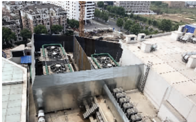
五楼顶部的冷却塔噪音让楼上住户苦恼 现代快报/ZAKER南京记者 孙玉春 摄
