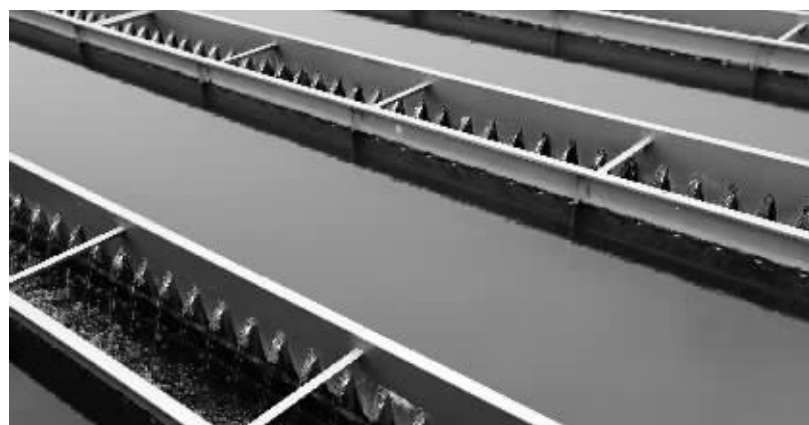
沉淀池末端,通过不锈钢的穿孔集水槽汇集清液,再输送至滤池
