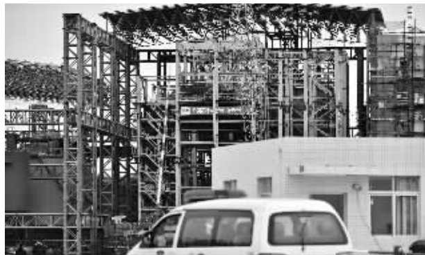
发生事故的在建广州第七热力发电厂厂区 新华社记者 梁旭 摄
