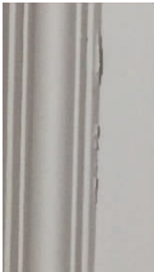
墙体的接缝处开裂了
