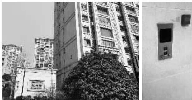
新小区京门府小区的电梯频繁“生病” 电梯处于断电状态
